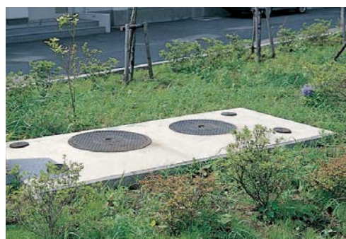
主タンク (埋設)
