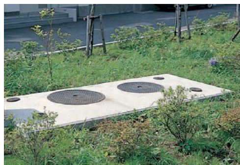
主タンク (埋設)
